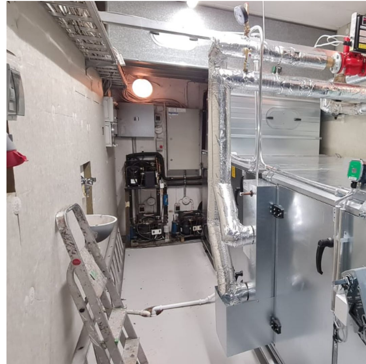
Päiväkodin konehuone saneerattu 2020-luvulle
